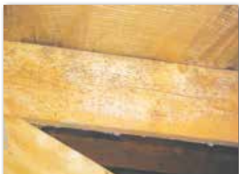
Råd og mug i tagkonstruktionen som følge af forkert udført efterisolering.
